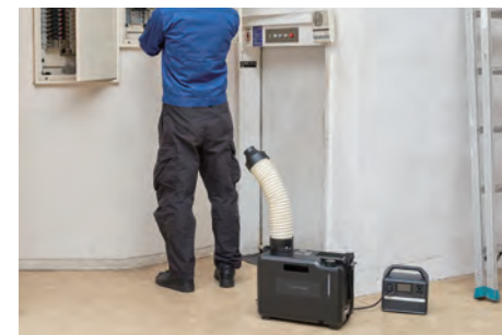
建物の設備メンテナンス
