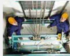
エレベータの出張点検に
